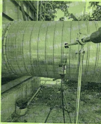
废气处理前取样口
